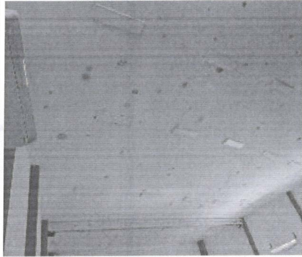
Se evidenció la presencia de goteras en el techo.
