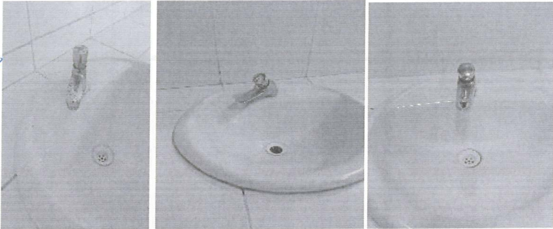
Fallas en el funcionamiento de los grifos de los caños.
