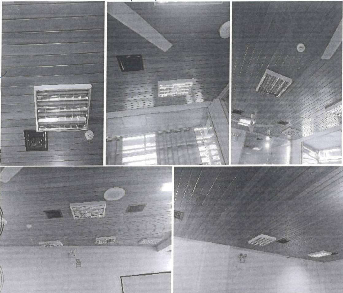
La mayoría de los focos presentan fallas y no encienden, principalmente los focos cuadrados.
